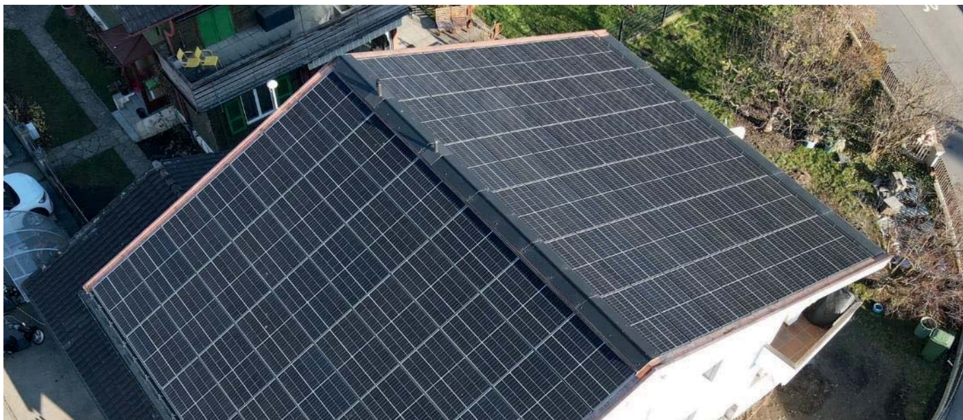
Photovoltaik-Anlage 30kWp, Wohn- und Geschäftshaus, Weissenaustrasse 19, 3800 Unterseen
